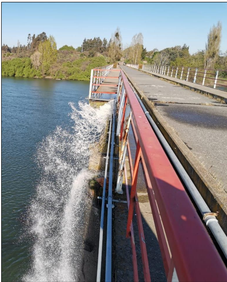
FIG. 2: Rotura junta de dilatación puente sifón octubre 2020.
