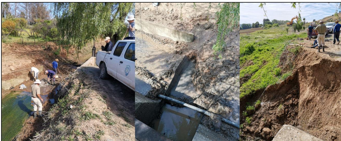
FIG. 6: Detalle rotura km 21 canal derivado Manantiales.
